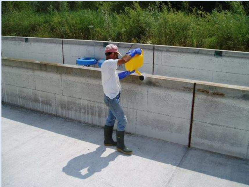
Trockene, gereinigte Becken
